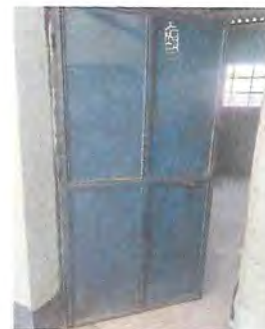
Foto 6: Puerta de aula deteriorada.
