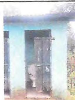
Foto 6: Puerta de sanitario incompleta.
