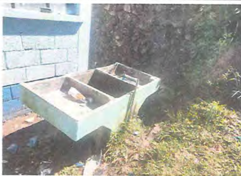
Foto 5: pila de cemento deteriorada.
